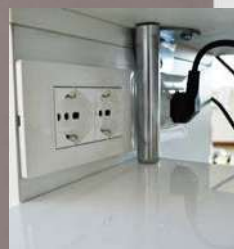
4 prese elettriche 4 sockets
