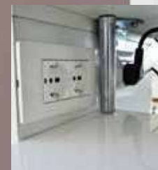
5 prese elettriche 5 sockets
